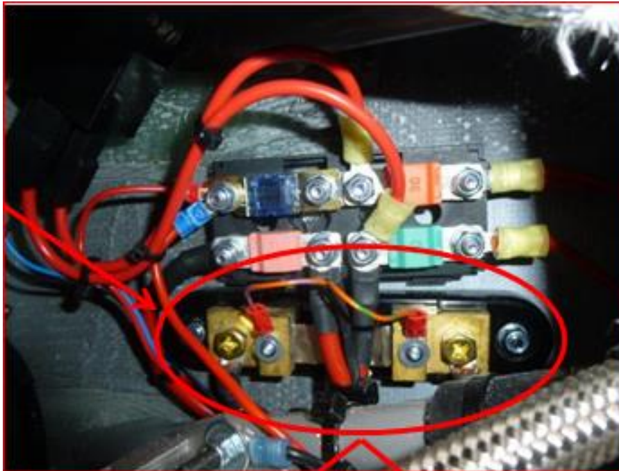
Bild 1: Shunt, alte Installation
