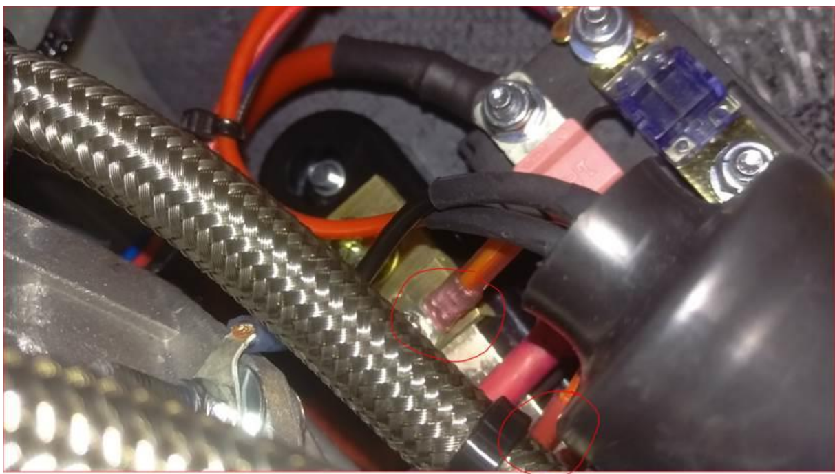
Bild 4: Shunt, neue Installation
